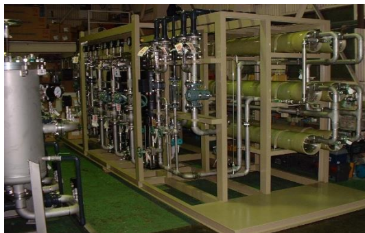
RO膜システム
