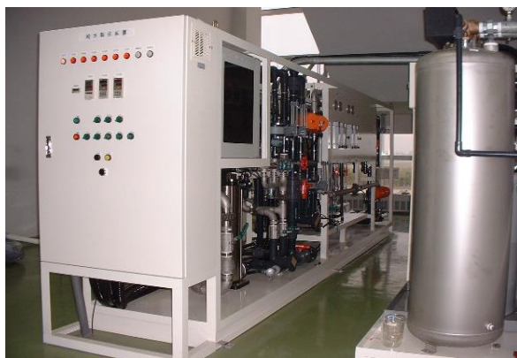
RO膜システム
