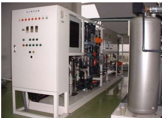
RO膜システム
